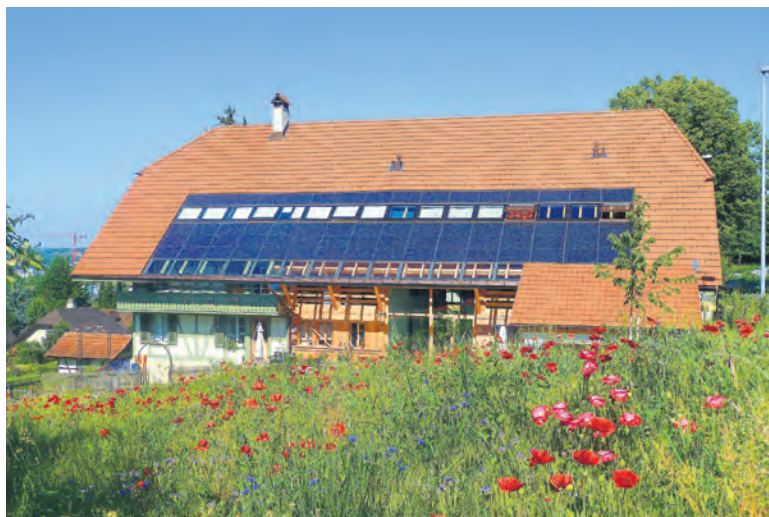
Photovoltaik-Anlage auf dem Bauernhaus von Alain Hofer
